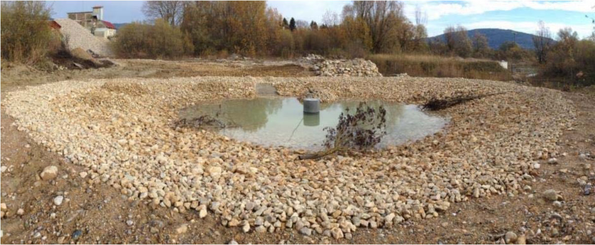
Figure 5. Plan d'eau bétonné sur bâche avec un système de vidange au centre (La Paulière, NE). Le béton a été couvert d'une couche de balaste. Espèce cible : Crapaud accoucheur
