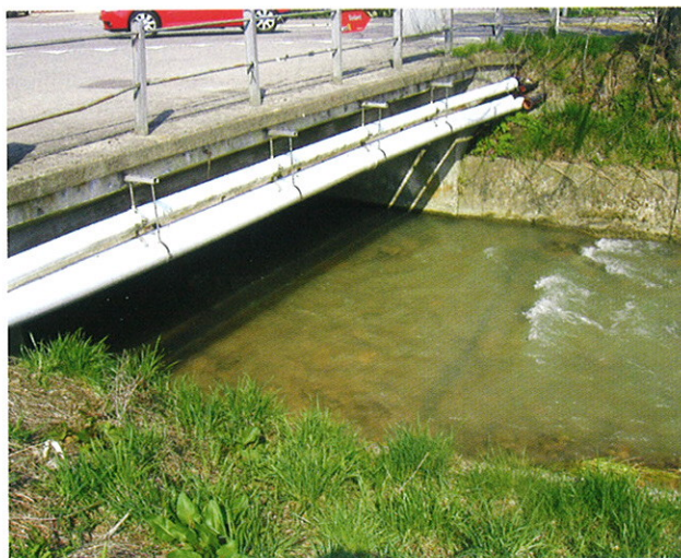
1: Für terrestrische Tierarten unüberwindbarer Gewässerdurchlass.
